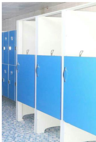
تصویر ۹. عرض نامناسب رختکن‌ها جهت استفاده معلولین با ویلچر در استخرهای مورد مطالعه
